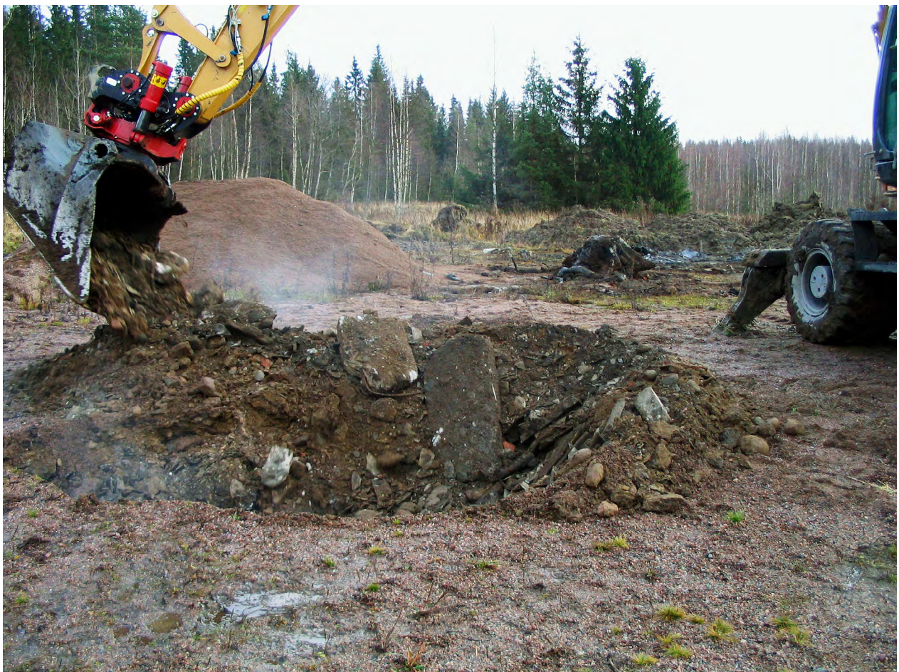
Kuva 2. Maaperään haudattu rakennusjätettä, kuvaaja Keskusrikospoliisi.
